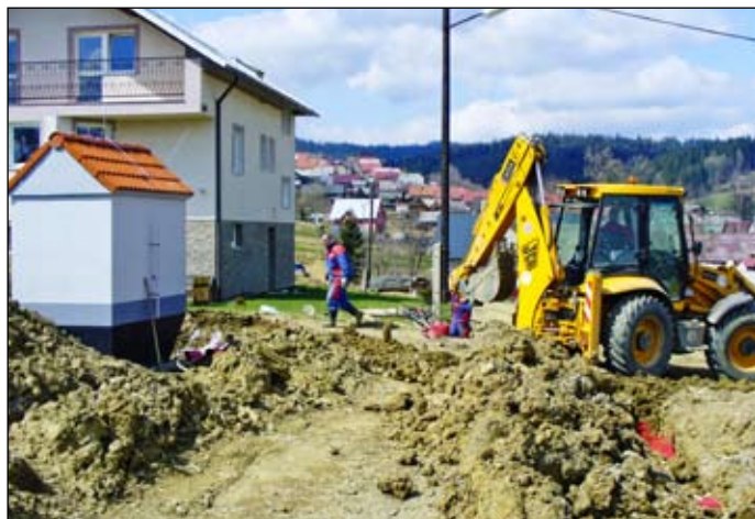
Na Kunovej ulici pribudla ďalšia trafostanica, ktorá umožní rozvod elektrickej energie pre nové domy
