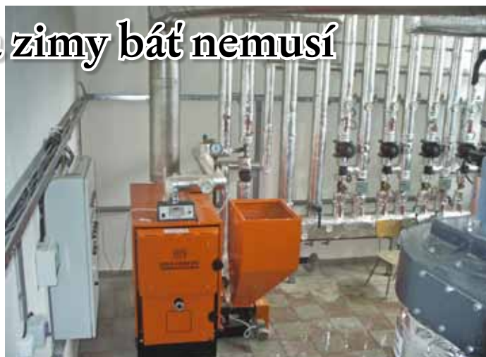
Kotolňa, pohľad na kotol 105 kW a vpravo je kotol 300 kW
