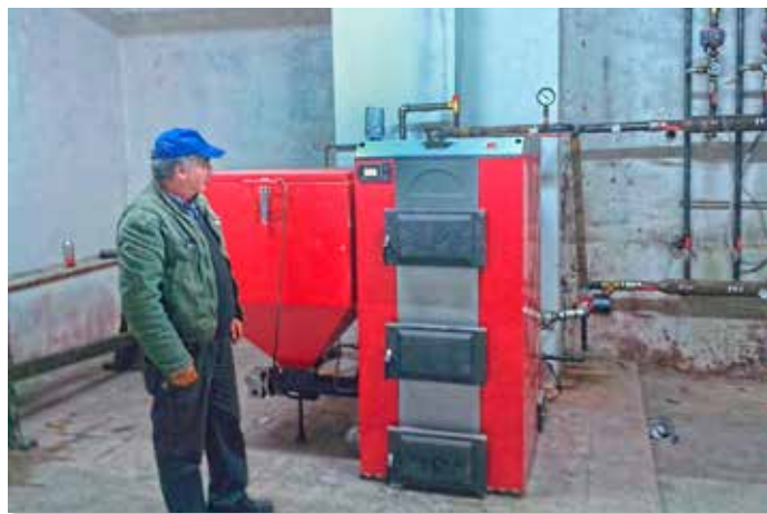
25. 9. 2013 Nová pec na vykurovanie kultúrneho domu pripravená
